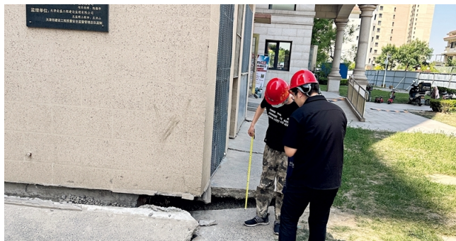
2023年6月7日，工作人员在天津碧桂园凤锦庭院小区测量地面沉降程度。沉降发生后，有高层住宅底部开裂明显，低层别墅则直接墙体开裂。图：牛牧江曲
